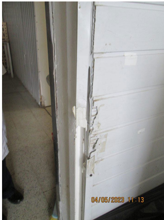
Obr. č.2 – ÚK 04.05.2023 – V časti, kde sa balia finálne výrobky bola zistená poškodená stena a roh.
