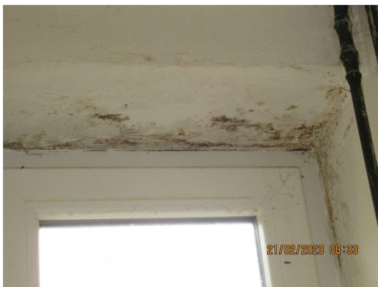
Obr. č.11 - ÚK 21022023 - Znečistenie v okolí okna.
