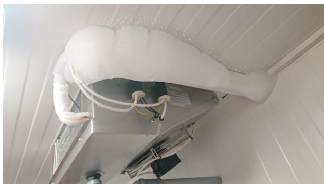
Obr. č.7 - ÚK 10.02.2023 - V chladiacom boxe v skladových priestoroch výskyt námrazy a kondenzátu.
