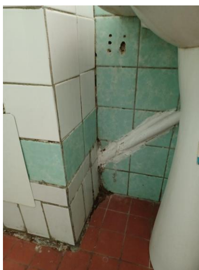
Obr. č.1 – ÚK 10.02.2023 - Steny v predsieni WC znečistené, poškodené, podlaha znečistená
