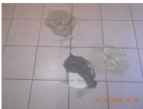
Obr. č.8 - ÚK 07.02.2023 - podlaha v sklade potravín nie je ľahko čistiteľná a udržiavaná v dobrom stave údržby - poškodená dlažba
