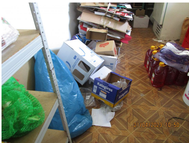
Obr. č.7 – ÚK 21.04.2023 - V zázemí prevádzky porozhadzované kartónové obaly, prepravky s pečivom uložené priamo na podlahe spolu so zvyškami plastových obalov - v zázemí prevádzky poškodený a popukaný strop.
