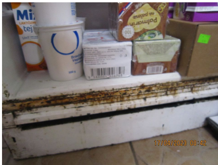
Obr. č.6 – ÚK 17.04.2023 - Kovová konštrukcia chladiaceho zariadenia skorodovaná a znečistená.
