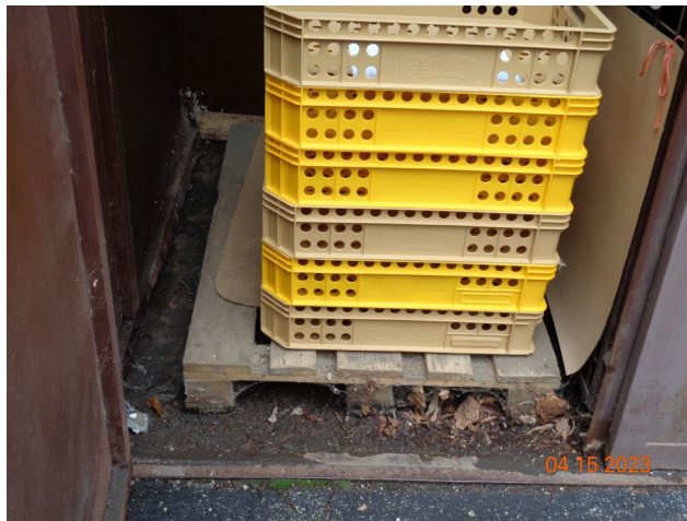
Obr. č.11 – ÚK 15.04.2023 - V skladovacích priestoroch pekárenských výrobkov silne znečistená podlaha prachom a špinou.
