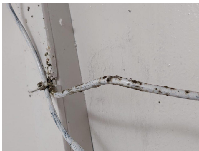
Obr. č.12 – ÚK 27.03.2023 - V chladiacom boxe v skladových priestoroch výskyt plesne na kábloch a na lište s uloženými káblami.
