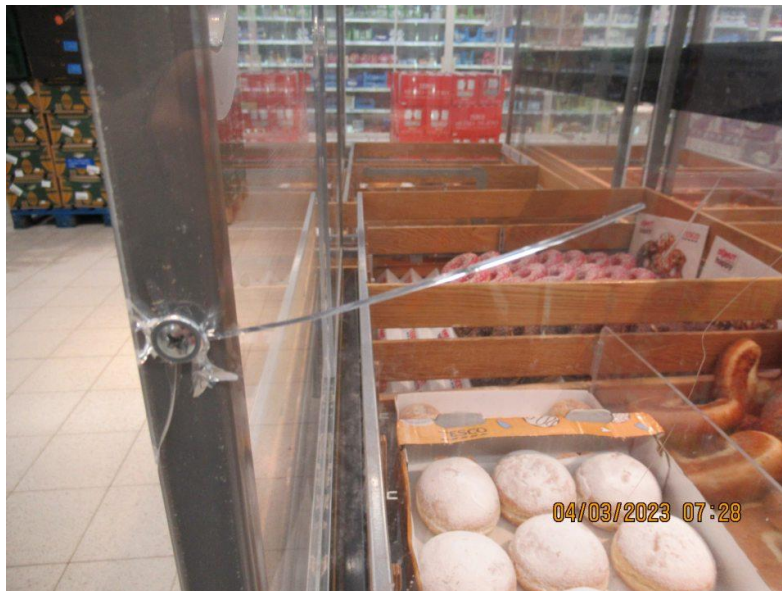
Obr. č.3 – ÚK 04.03.2023 - Prasknutá bočná stena technického zariadenia na predajnej ploche slúžiaceho na uchovávanie nebalených rozmrazovaných pekárskych výrobkov.
